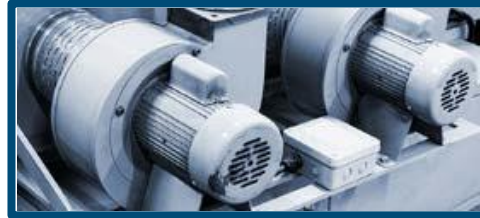
Kanalnetzoptimierung bei Absauganlagen
